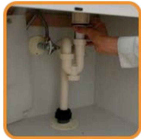
キッチン配水管の漏水確認
