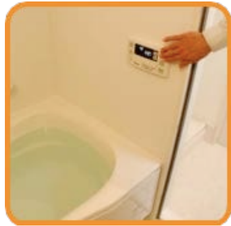
給湯の温度確認
