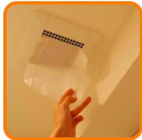
トイレ換気扇の動作確認
