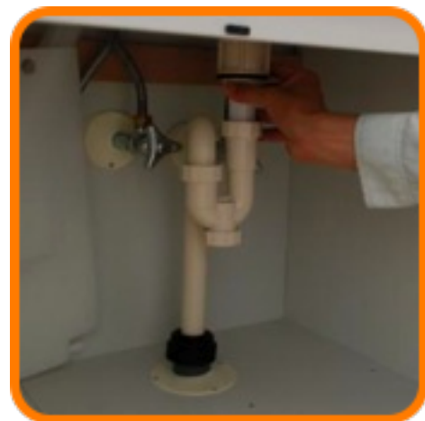
キッチン配水管の漏水確認
