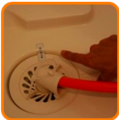
洗濯パンの溢れ確認 (1)
