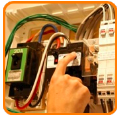
漏電ブレーカーのテスト
