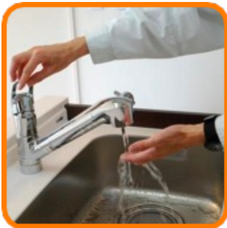
給湯の吐水確認
