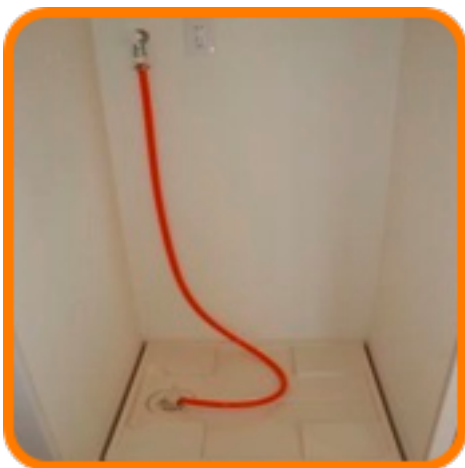
洗濯パンの溢れ確認 (2)
